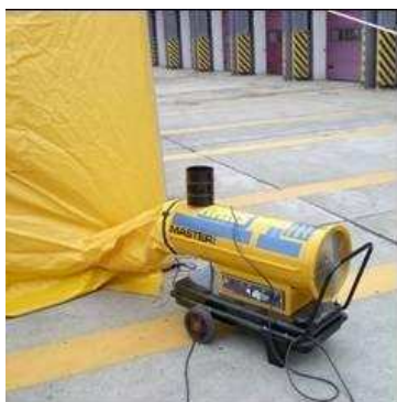
Nagrzewnica 20 kW podłączona namiotu NPA
